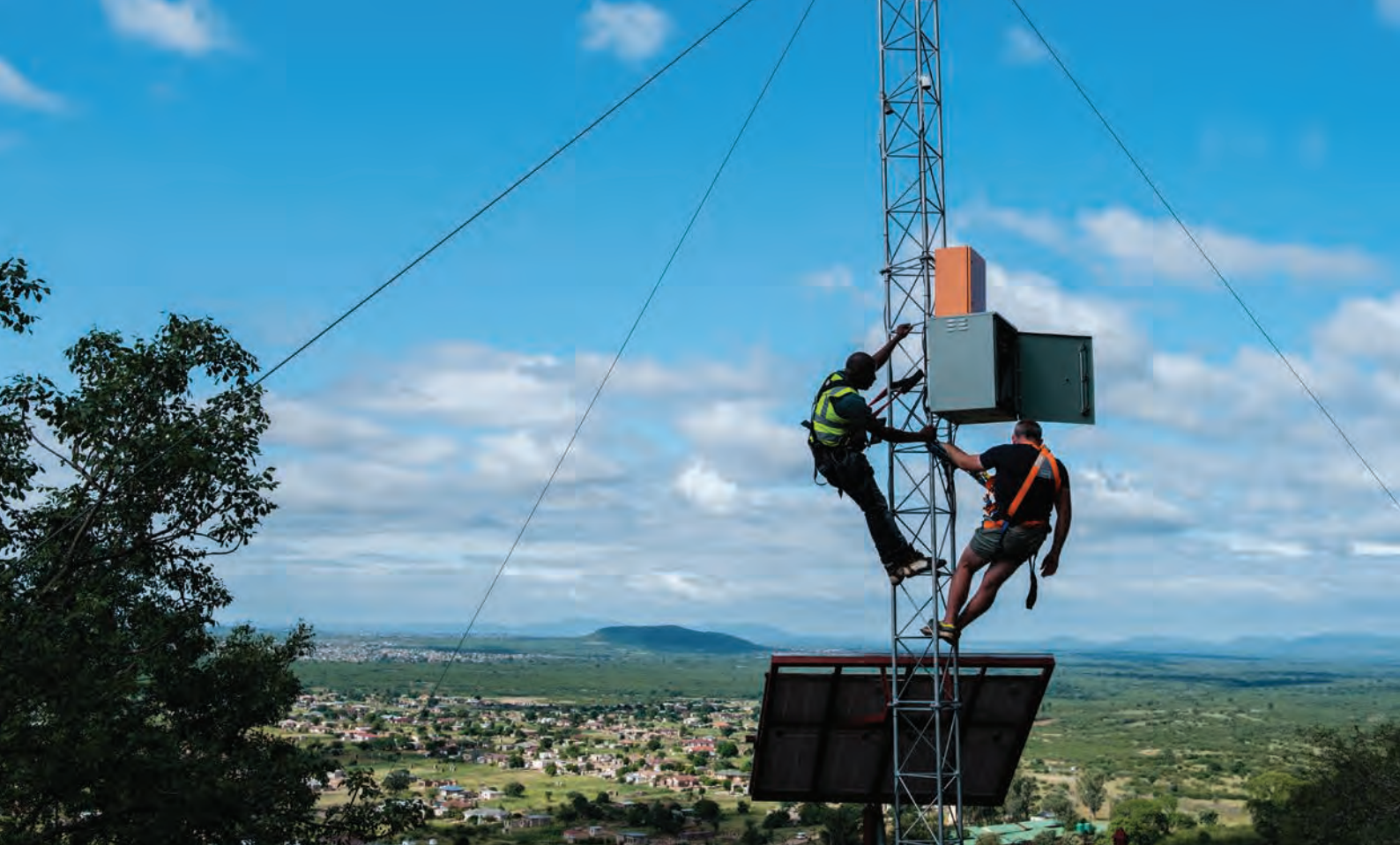
Pardon Mabunda (izquierda) y Stephan Jacobs en una torre perteneciente a la red comunitaria de Mamaila en una colina sobre el pueblo de Sephukubje, en la provincia de Limpopo, en Sudáfrica, preparándose para instalar baterías adicionales para mejorar la confiabilidad de la torre.
